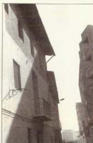
Edifici del carrer Joaquín Orero, amb ràfec sobreelèixit i balcó voladís. Fotografia d'Antoni Tomàs.
